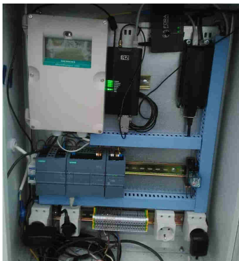
Рис. 2. Зовнішній вигляд монтажного контейнера «ГІС Дністер» з контрольно-вимірювальним, керуючим і комунікаційним обладнанням
